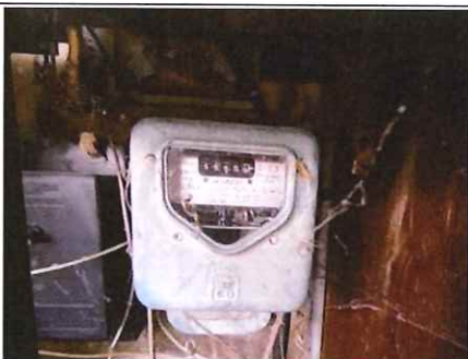
Photo du Compteur électrique
