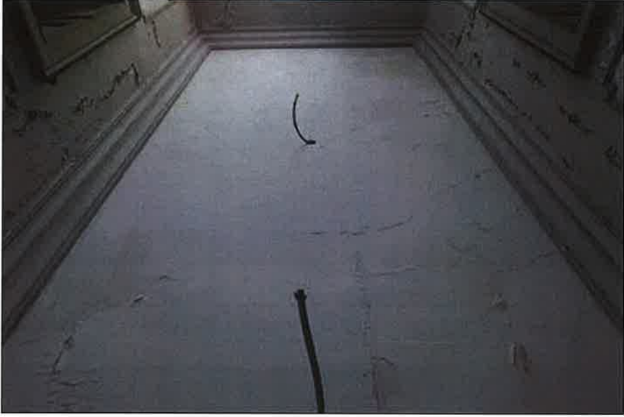
Le plafond est en plâtre peint, la peinture est fissurée et s'écaille. Cette pièce est en travaux. Nous retrouvons les gaines électriques en attente.
