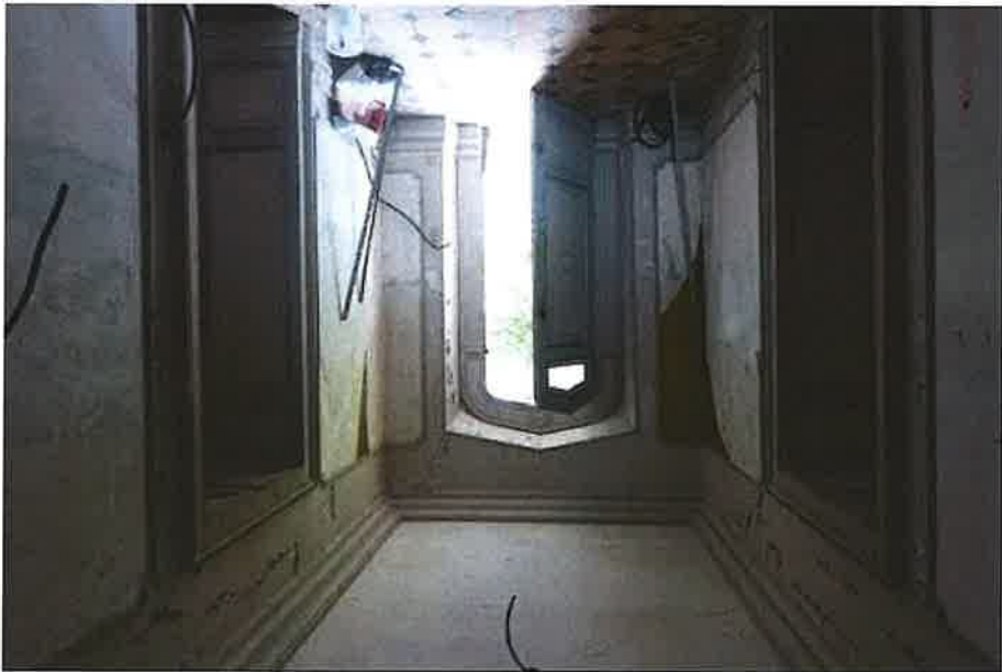
Les murs sont bruts, la tapisserie a été arrachée, la peinture s'écaille.
