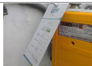
Photo n° du Compteur Gaz
